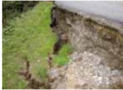
Böschung rutscht weg
