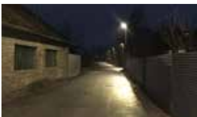
Erweiterung - Straßenbeleuchtung Eisenhammerstraße
