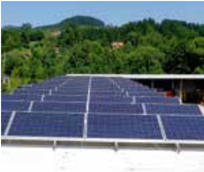
Photovoltaikanlage der Marktgemeinde Krieglach - Produktion 15.000 kWh pro Jahr
