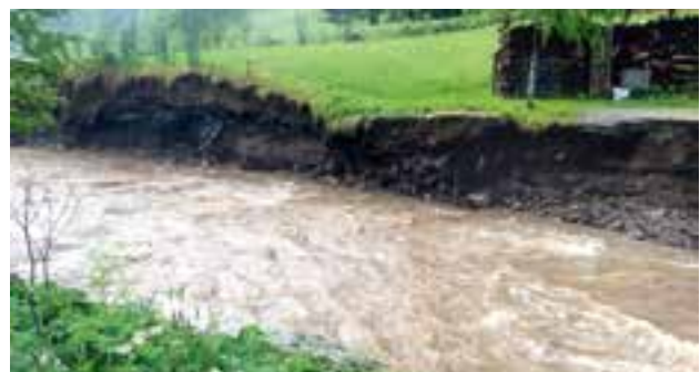
Hochwasser Freßnitzbach - Ufererisse
