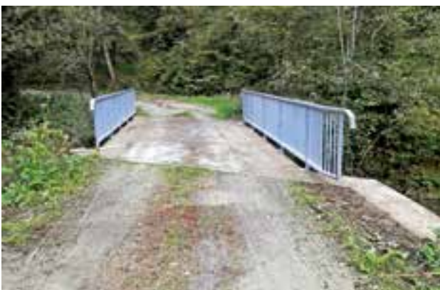
Die Überfahrtsbrücken über den Freßnitzbach wurden von der Marktgemeinde Krieglach mit Geländern ausgestattet
