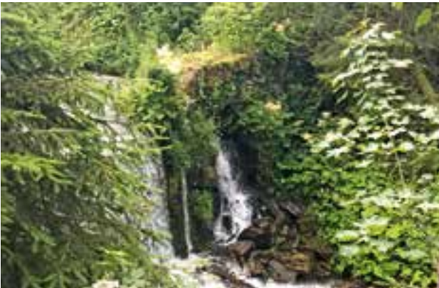
alte, baufällige Geschiebesperre
