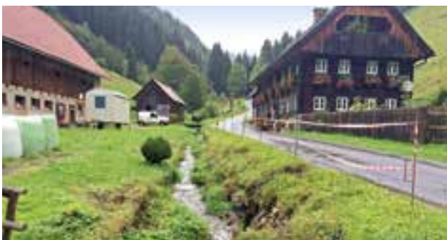
Ufereinrisse beim Massingbach
