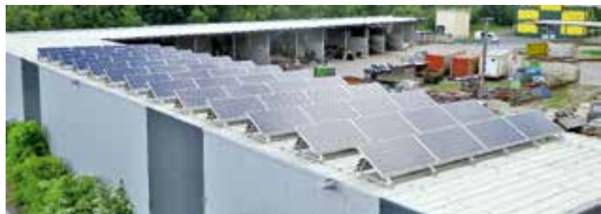
alle, die bestehende und die neuen, Photovoltaikanlagen werden in Zukunft rund 65.000 kWh/Jahr erzeugen
